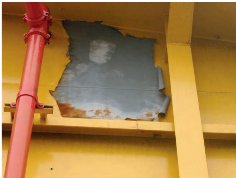
Obr. 1: Odlup nátěr. systému ve vrstvě nedostatečně vytvrzeného ZSN primeru + vrchní epoxid
