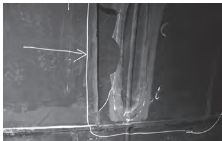
Obr. 4: Místní šetření, tzv. větší defekt s vyznačenou zónou porušení pogumování v oblasti lepeného spoje
